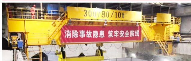
国家能源集团 300吨双梁起重机
