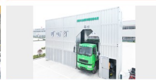
远程本途 集装箱重卡充换电站
