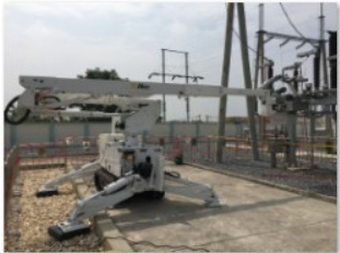
湖北电科院110kV变电站带电作业机器人项目
